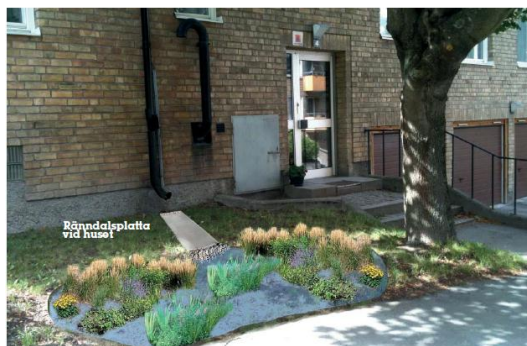
EFTER: NEDSÄNKT GRÄS Bortkoppling av stuprör. Utkastare och översilning på nedsänkt gräsyta.
